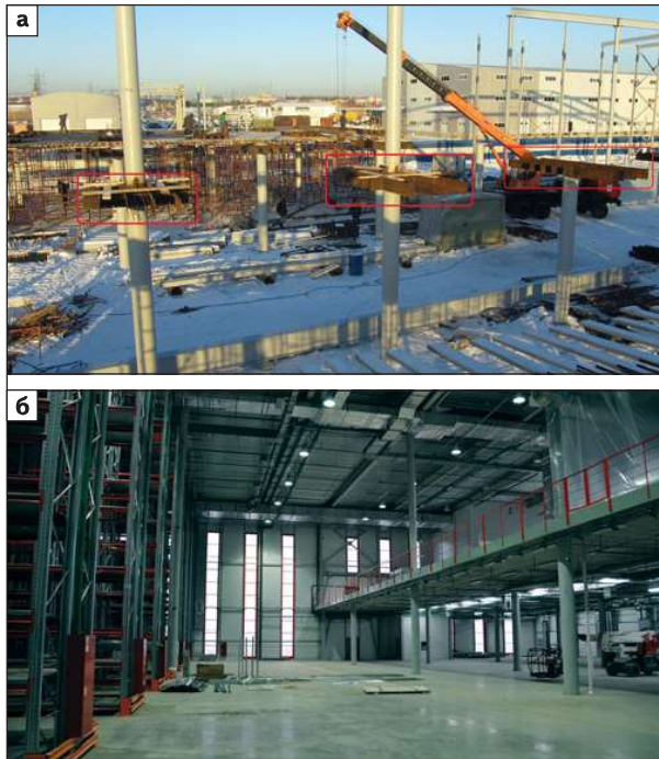
Рис. 1. Возведение (а) и реализация (б) безбалочного перекрытия (красными прямоугольниками показаны СМК с последующей установкой ГЛА)
